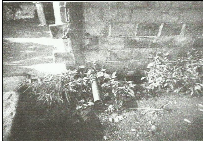
Photo 1: un conduit d'évacuation d'eau usée orienté sur la voie publique
